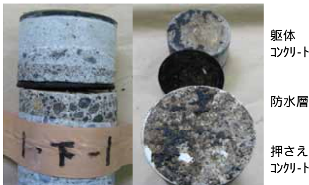
写真1 コア抜き採取した防水層の例(試料 )
