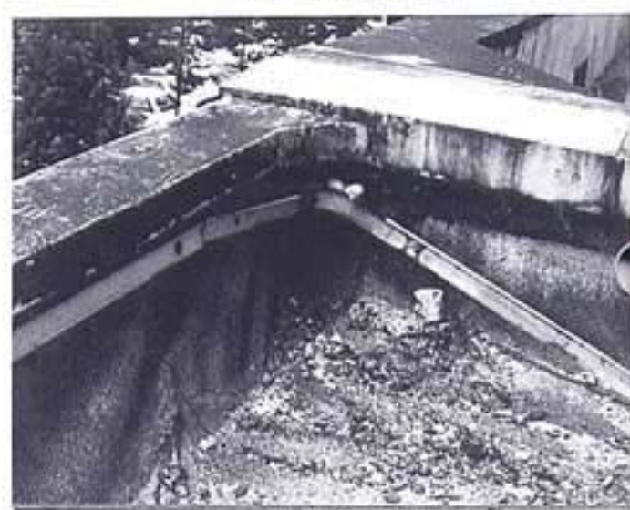
押え金物の脱落
