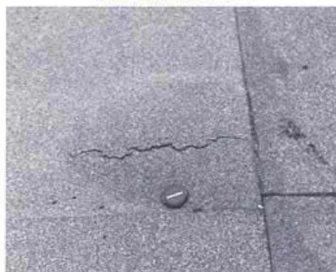
防水層の表層のひび割れ
