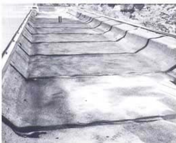
防水層のふくれ
