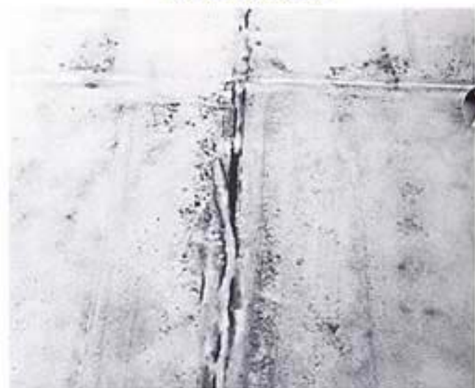
防水層のひび割れ
