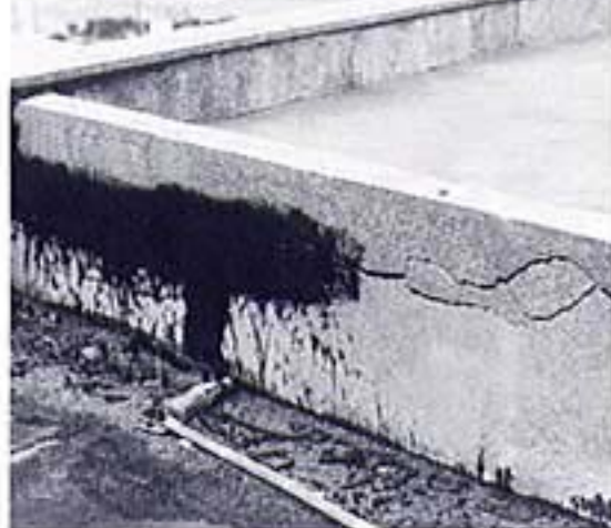
立上がり保護層のひび割れ
