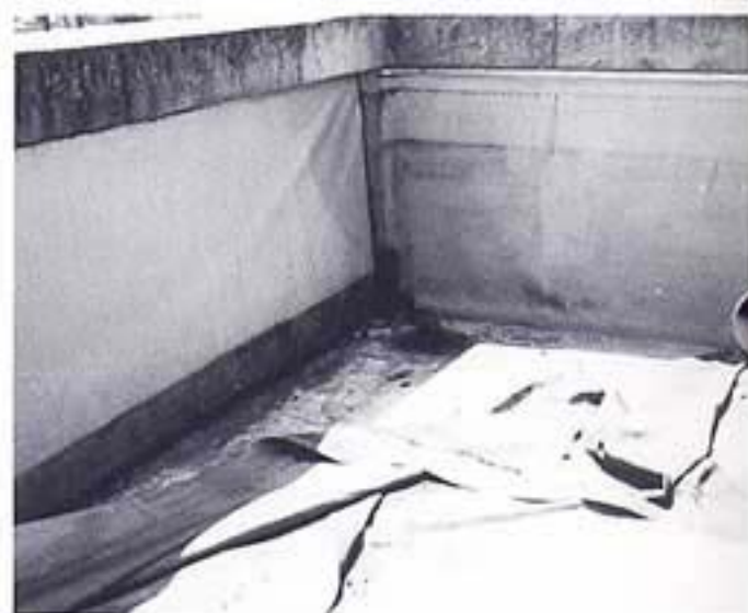
防水層の剥離
