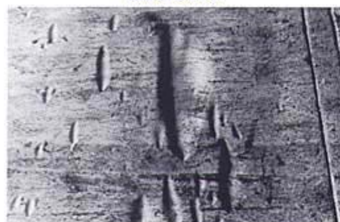
防水層のふくれ
