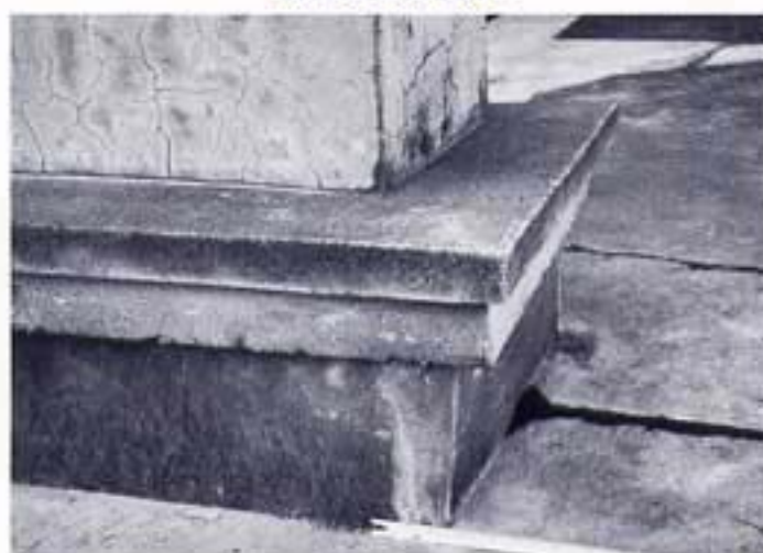
架台のひび割れ
