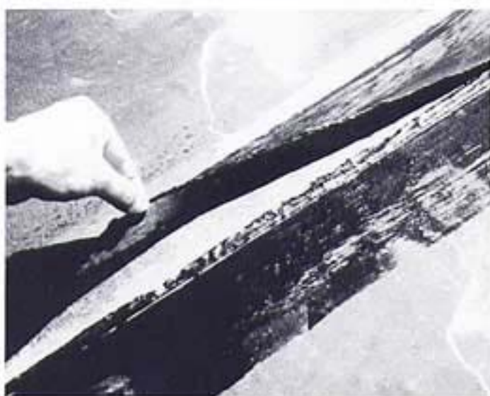
接合部の剥離
