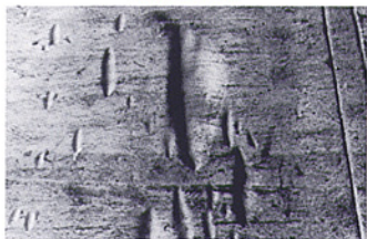
防水層のふくれ
