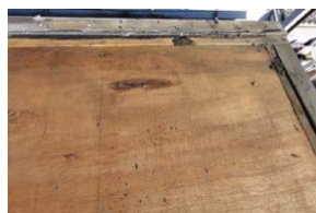
図6 漏水痕(乾燥状態)
