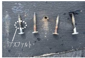
図4 釘にアスファルトが付着
