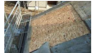
図8 野地板の状態
