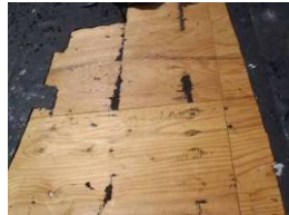
図2 野地板の状態
