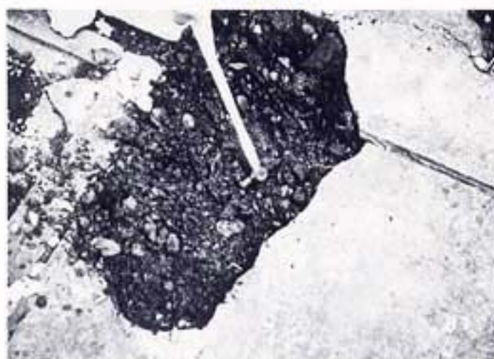
保護層の破損
