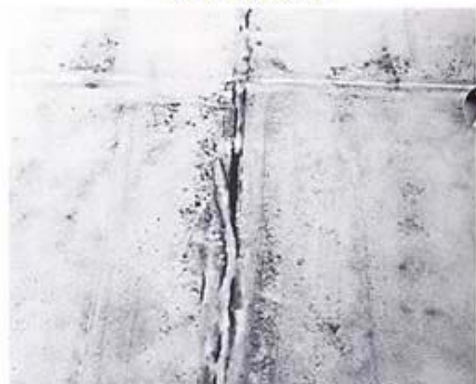
防水層のひび割れ
