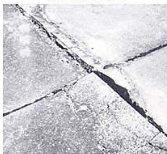
保護層のせり上がり
