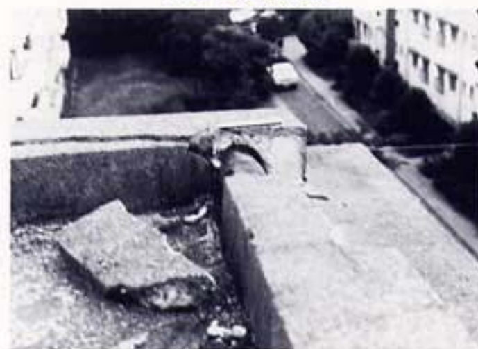
パラベットの損壊
