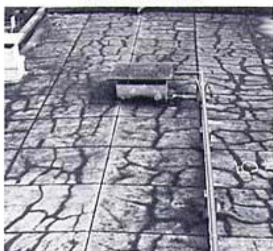
保護層のひび割れ
