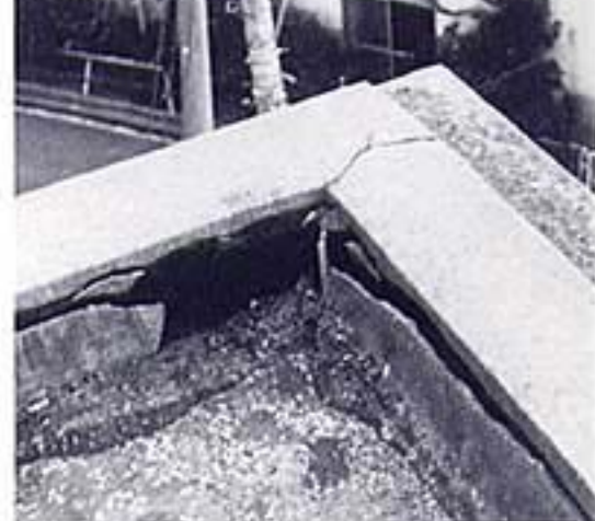
立上がり保護層の倒壊、笠木のひび割れ
