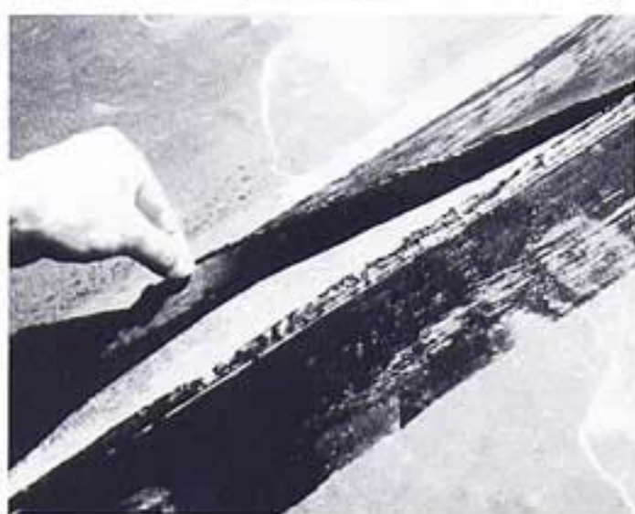
接合部の剥離
