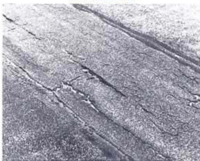
防水層の貫通破断
