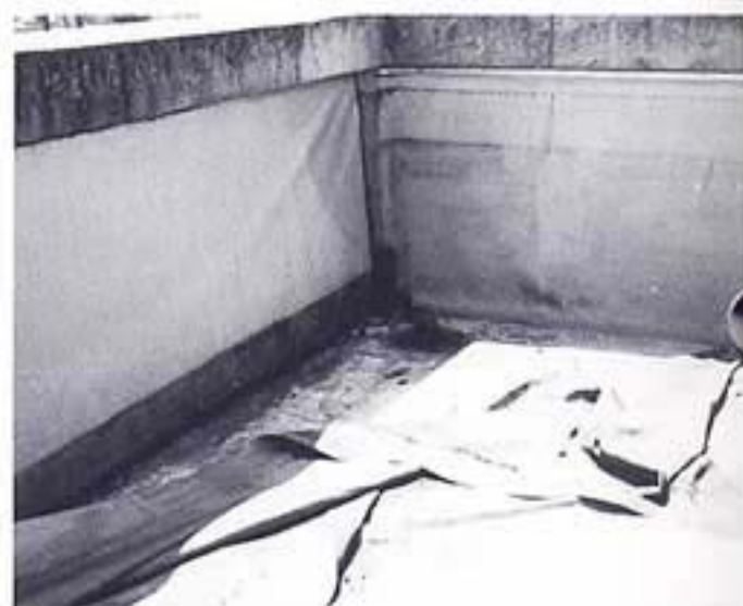
防水層の剥離
